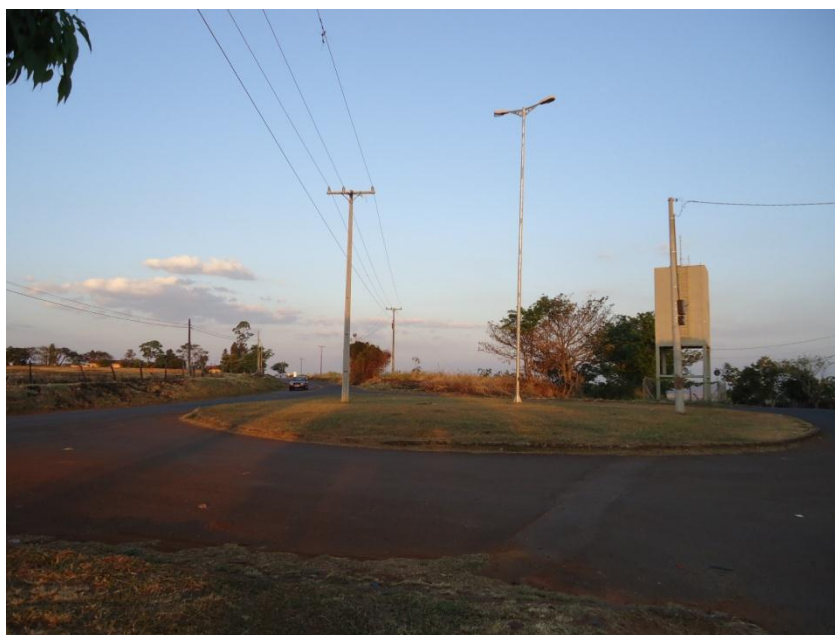
Figura 32: Vista das instalações da iluminação pública na Avenida Guilherme de Almeida.
