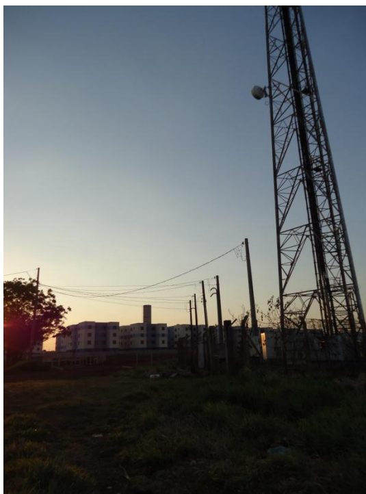
Figura 36: Detalhe das instalações elétricas nos limites do empreendimento.
